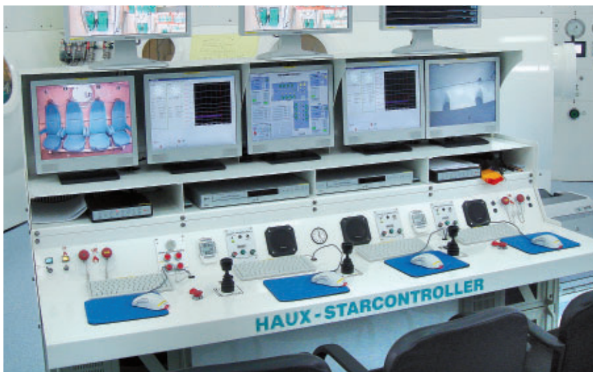
La console de commande du nouveau caisson.
