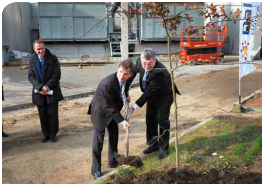
Jean-Jacques Romatet, directeur général du CHU et Christian Labeyrie, directeur régional Dalkia France le 13 décembre 2012, lors de la visite du chantier de la future chaufferie biomasse du site de Purpan.
