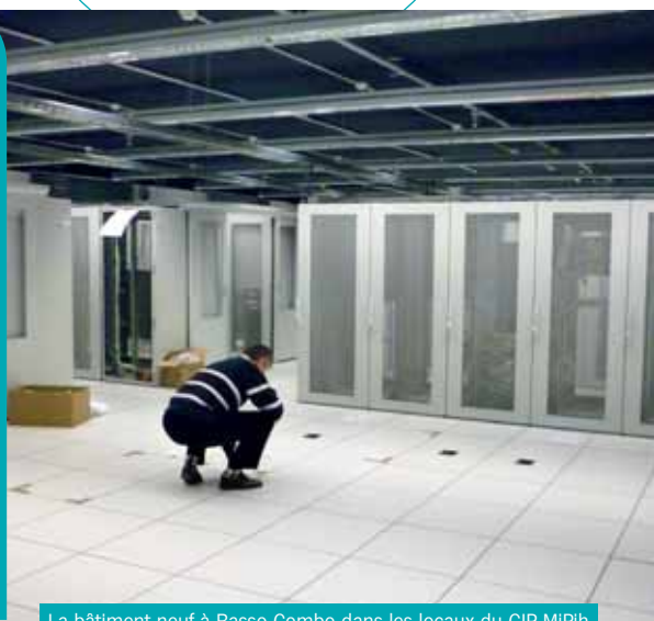
La bâtiment neuf à Basso Combo dans les locaux du GIP MIPIH
